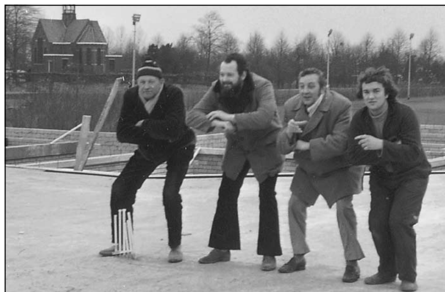
Na het storten van de verdiepingvloer wist het viertal Gert van den Hoek, Nico van Vliet, Bep Sluys en Harry Boere exact aan te geven waar de bar zou komen.
